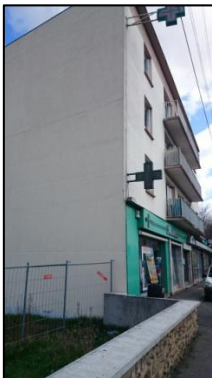
Photo N° 343 ECH-N°46 -- Batiment calmette pignon Murs Enduit+peinture
