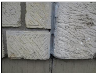
Photo N° 2894 ECH-N°34 -- Batiment 28-36 republique façade parking Murs Joint de dilatation+mousse
