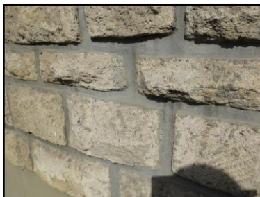
Photo N° 2885 ECH-N°27 -- Batiment Ambroise façade parking Murs Joint entre pierres
