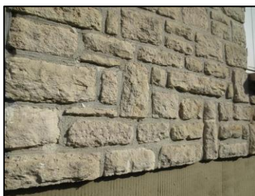
Photo N° 2854 ECH-N°11 -- Batiment 23-31 republique façade jardin Murs Joint entre pierres
