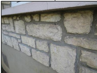
Photo N° 2863 ECH-N°17 -- Batiment Laennec façade jardin Murs Joint entre pierres
