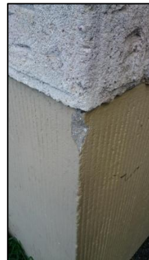
Photo N° 345 ECH-N°48 -- Batiment calmette façade arrière Murs soubassement béton+peinture
