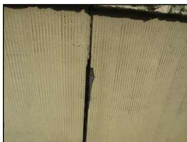
Photo N° 2853 ECH-N°10 -- Batiment 23-31 republique façade jardin Murs soubassement béton+peinture
