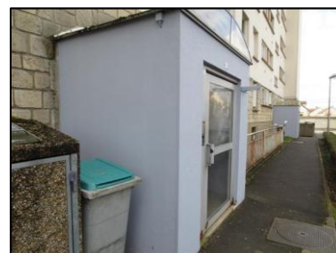
Photo N° 2898 ECH-N°38 -- Batiment 28-36 republique façade parking Murs hall extérieur béton+peinture
