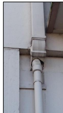
Photo N° 352 ECH-N°54 AMIANTE CIMENT --Batiment calmette façade entrée 27 Murs C onduit de Ventilation (Fibres- ciment)
