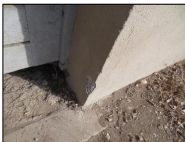
Photo N° 2857 ECH-N°14 -- Batiment 23-31 republique façade jardin Murs béton+peinture marron
