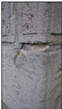
Photo N° 346 ECH-N°49 -- Batiment calmette façade arrière Murs Joint entre pierres
